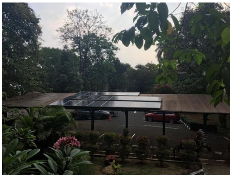
Gambar 3.5. 12 Solar Panel di atap Parkir Pimpinan Gedung A
