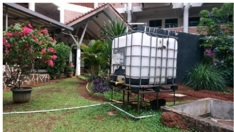
Penampungan air kondensasi AC
