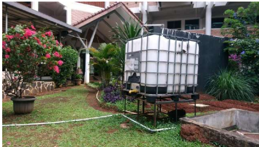
Penampungan air kondensasi AC
