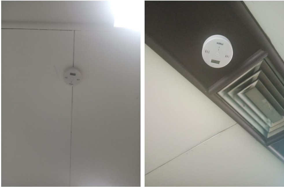
Smoke detector di Ruang Lab Gizi dan Lab TPKK
