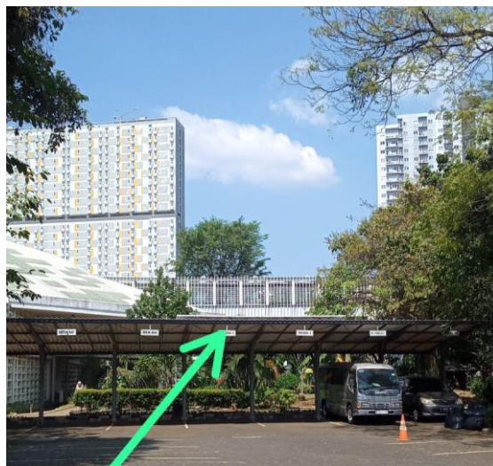
Solar Panel di atas Parkir Pimpinan
