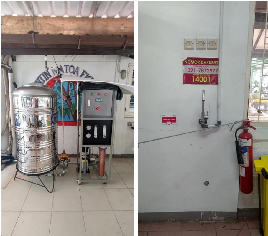
Pengolahan Air Cuci Kantin
