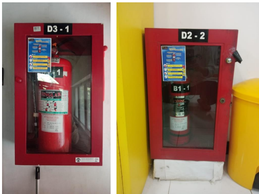
APAR di setiap gedung dan lantai
