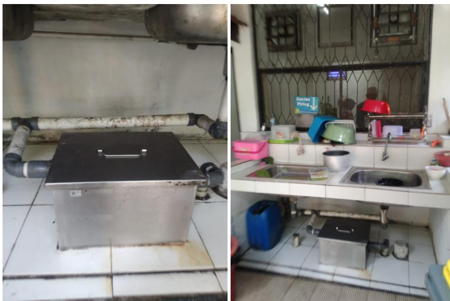
Grease Trap Control di tempat cuci piring Kantin Matoa FKM UI
