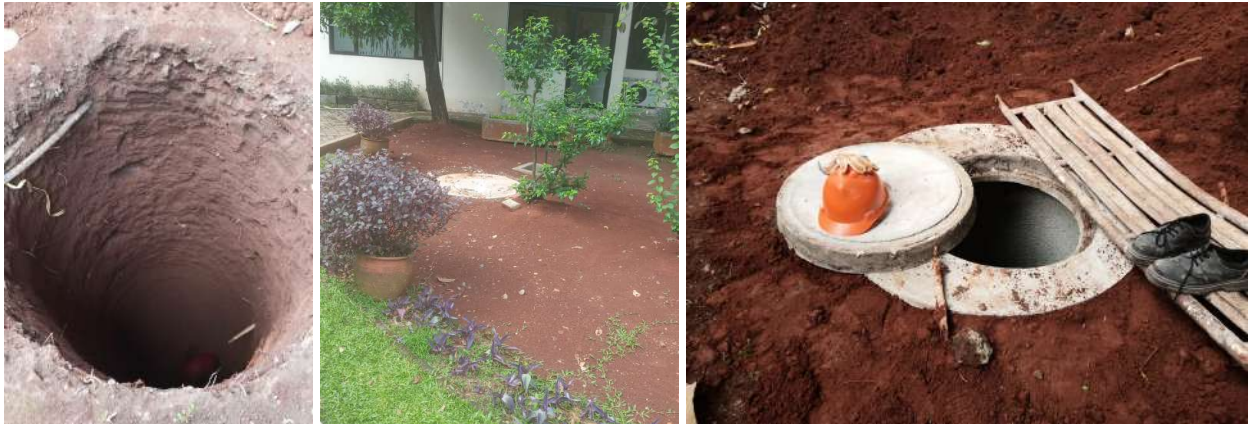
Sumur Resapan di Gedung B FKM UI
