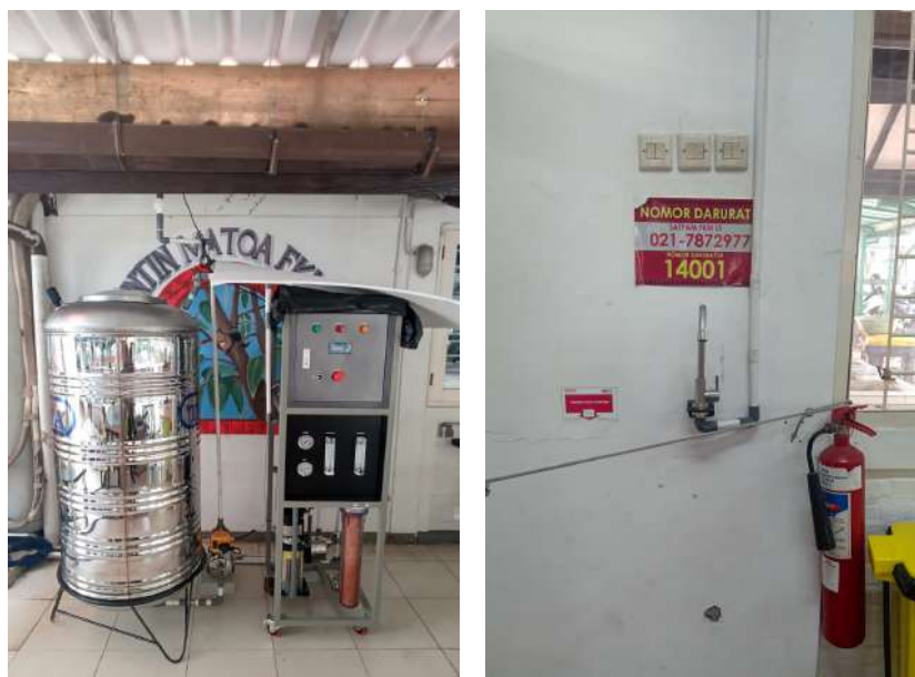
Pengolahan Air Cuci Kantin
