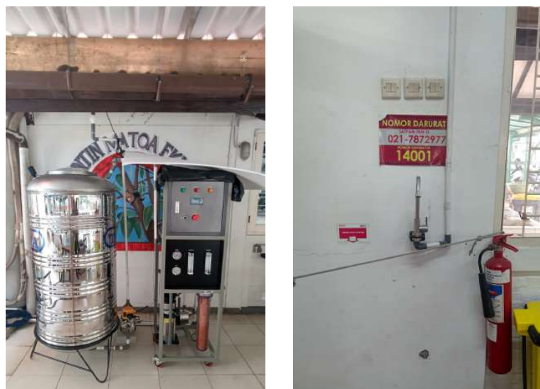
Pengolahan Air Cuci Kantin
