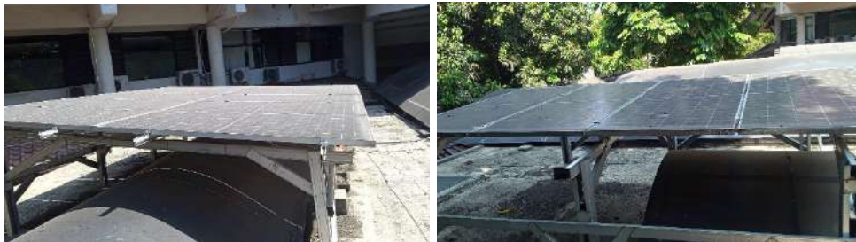
Penyediaan Solar Panel Sebagai Sumber Energi Terbarukan
