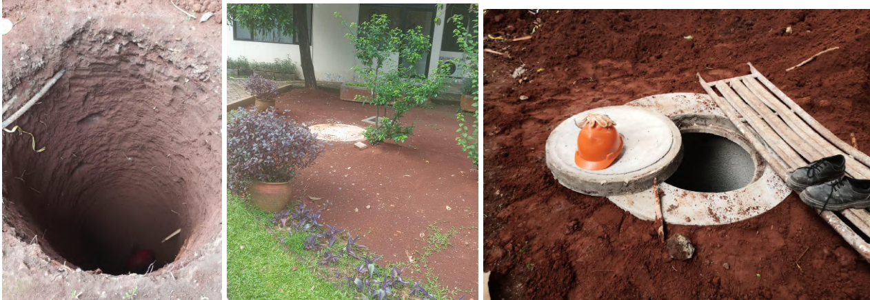
Sumur Resapan di Gedung B FKM UI
