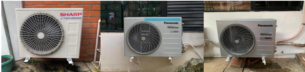
AC Inverter di ruang-ruang Fakultas
