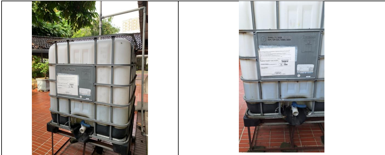
Penampungan limbah air kondensasi AC
