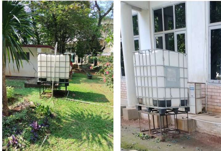
Penampungan Limbah Air Kondensasi AC
