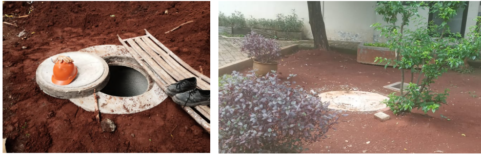
Sumur Resapan Air
