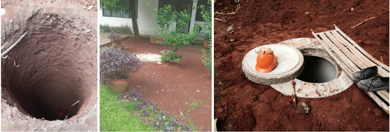
Sumur Resapan di Gedung B FKM UI
