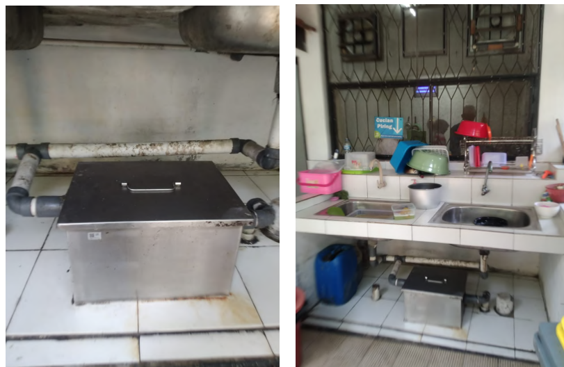
Grease Trap Control di Tempat Cuci piring Kantin Matoa FKM UI
