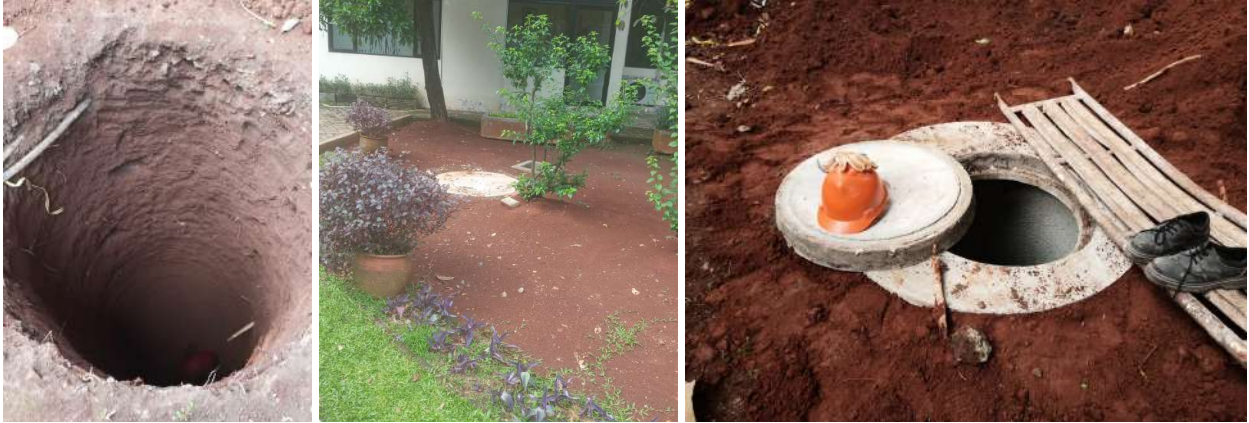
Sumur Resapan di Gedung B FKM UI
