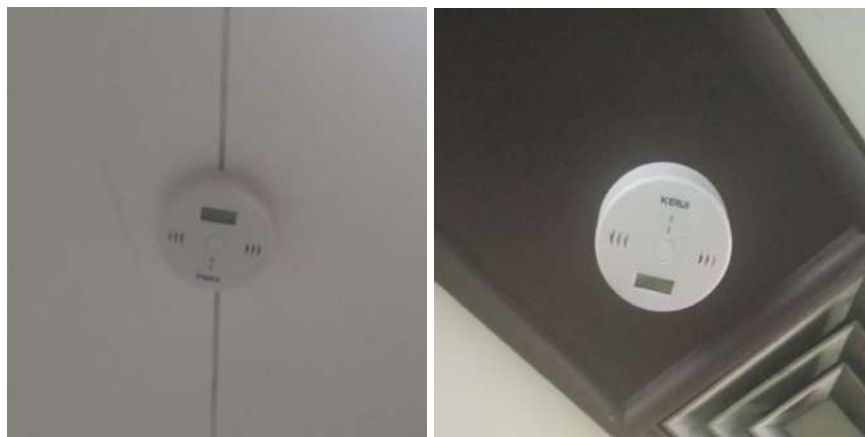
Smoke Detector di Ruang Lab Gizi dan Lab TPKK
