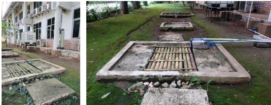
Penampungan Air Hujan di Ground Tank yang Difiltrasi Menjadi Air Bersih
