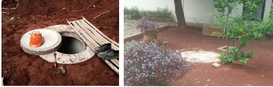
Sumur Resapan Air
