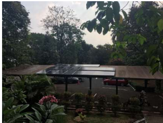
Solar Panel di Kantin Sehat/Parkir Mobil Pimpinan FKM UI
