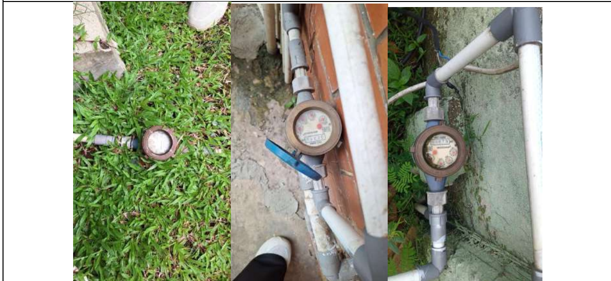
Pengukuran meteran air yang dilakukan secara rutin
