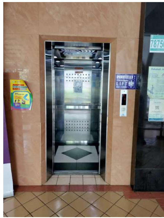
Lift untuk Kelompok Rentan di Gedung G
