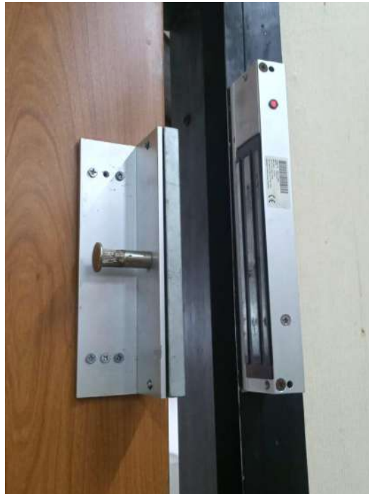
Automatic Door Lock System di setiap Gedung dan ruang kerja
