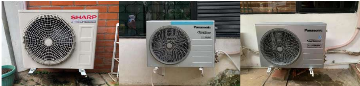
AC Inverter di ruang-ruang Fakultas
